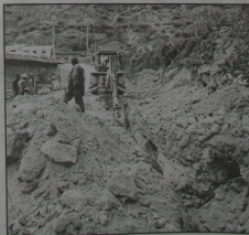
Las vías de Cusco han colapsado en diversos tramos, por ello los transportistas deben ser precavidos.
